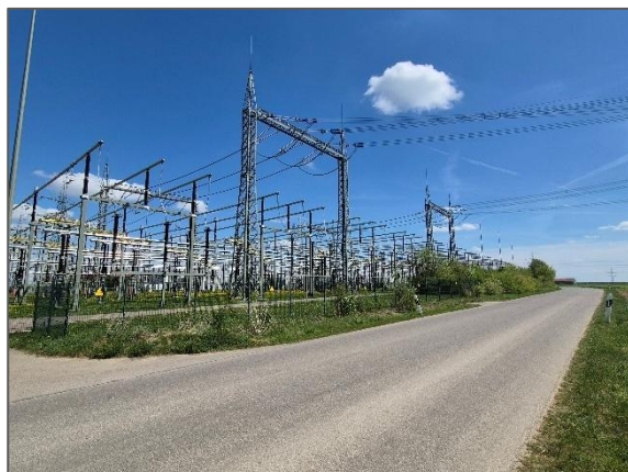
Abbildung 10: Umspannwerk der Amprion GmbH
