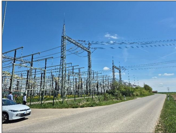
Abbildung 26: Blick vom Geltungsbereich auf das benachbarte Umspannwerk der Amprion GmbH
