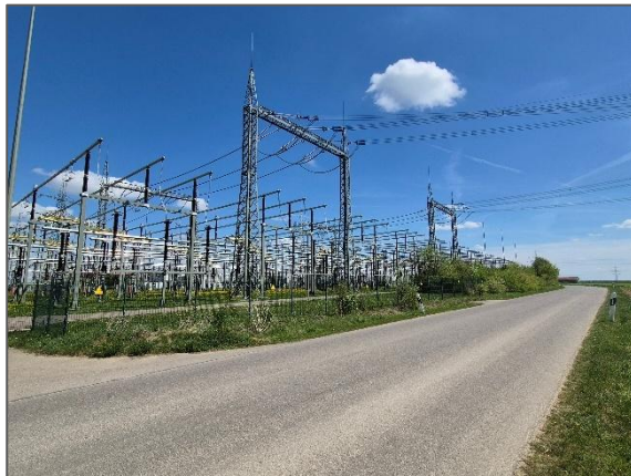
Abbildung 9: Umspannwerk der Amprion GmbH
